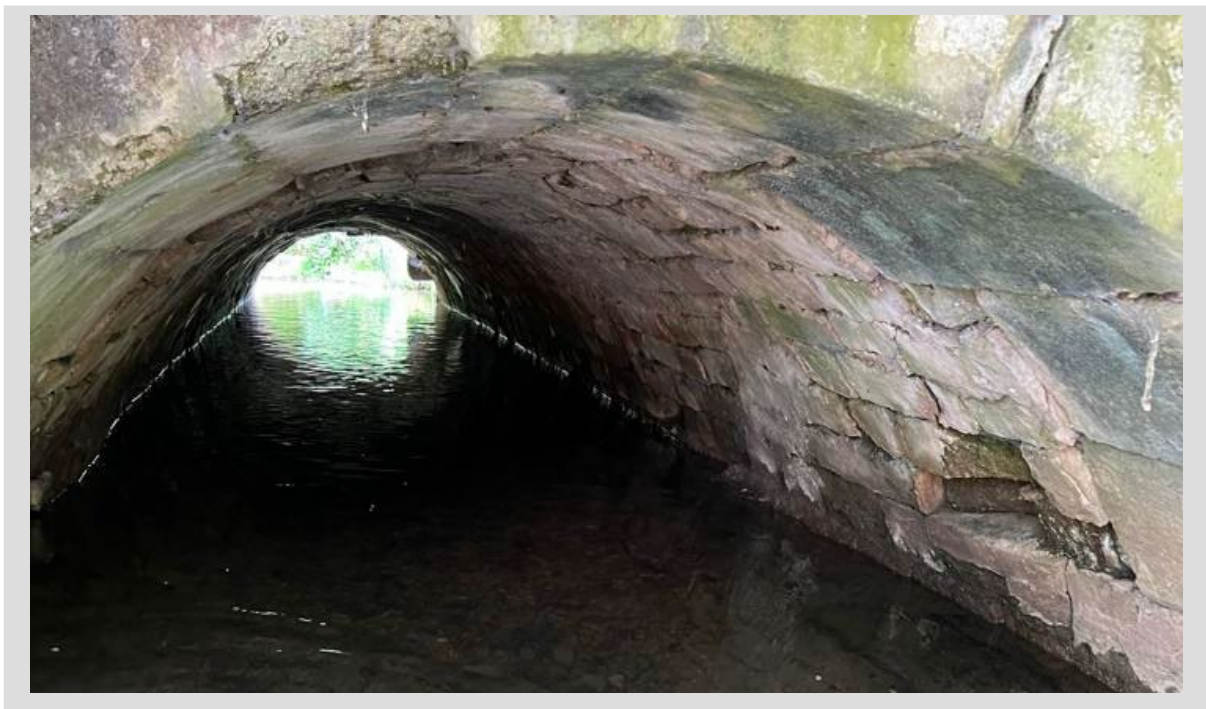
Figure 1 Etat de la voute de l'ouvrage
