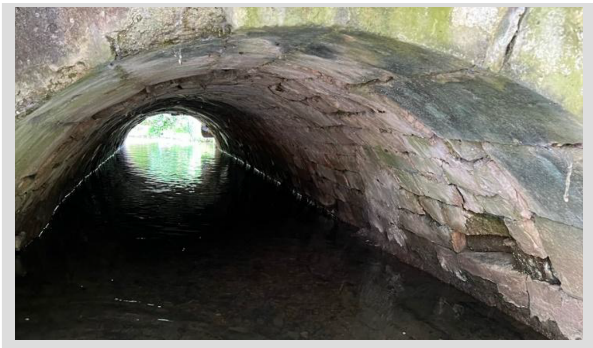
Figure 1 Etat de la voute de l'ouvrage
