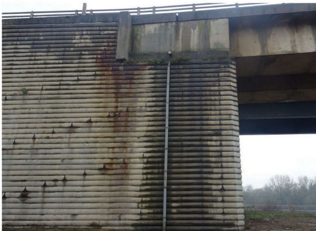
Figure 2: Ruissellement d'eau le long des écailles
