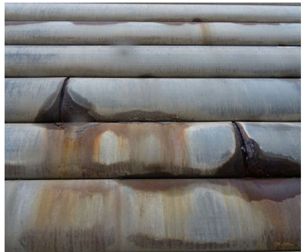
Figure 3: Corrosion des écailles métalliques
