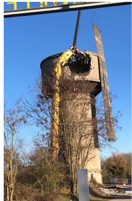
Figure 4: Exemple de grignotage d'un château d'eau
