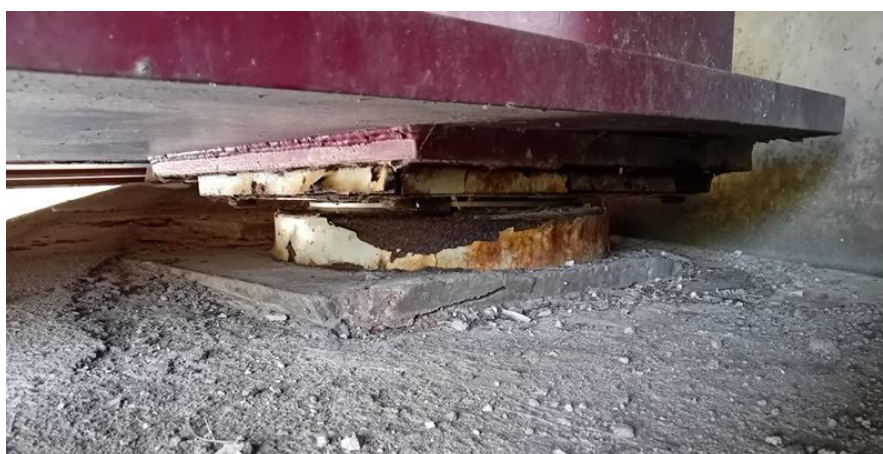
Pont de la RN57 à Voray-s-l'Ognon – vue des appareils d'appuis corrodés
