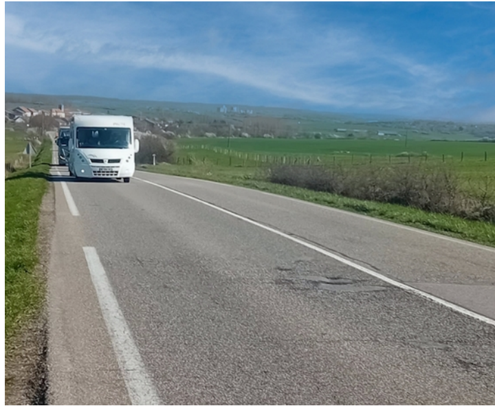
état actuel de la chaussée, nécessitant une réfection globale en profondeur
